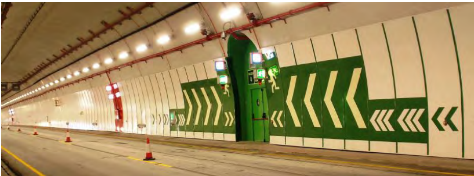
Imagen 54. Salida de emergencia -color verde- en túnel.
